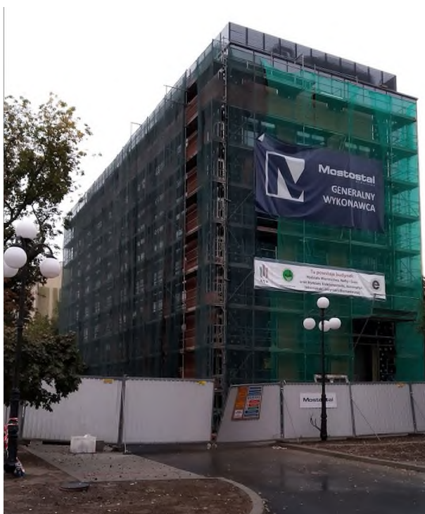
Przed montażem i demontażem rusztowania należy wyznaczyć i ogrodzić strefę niebezpieczną
